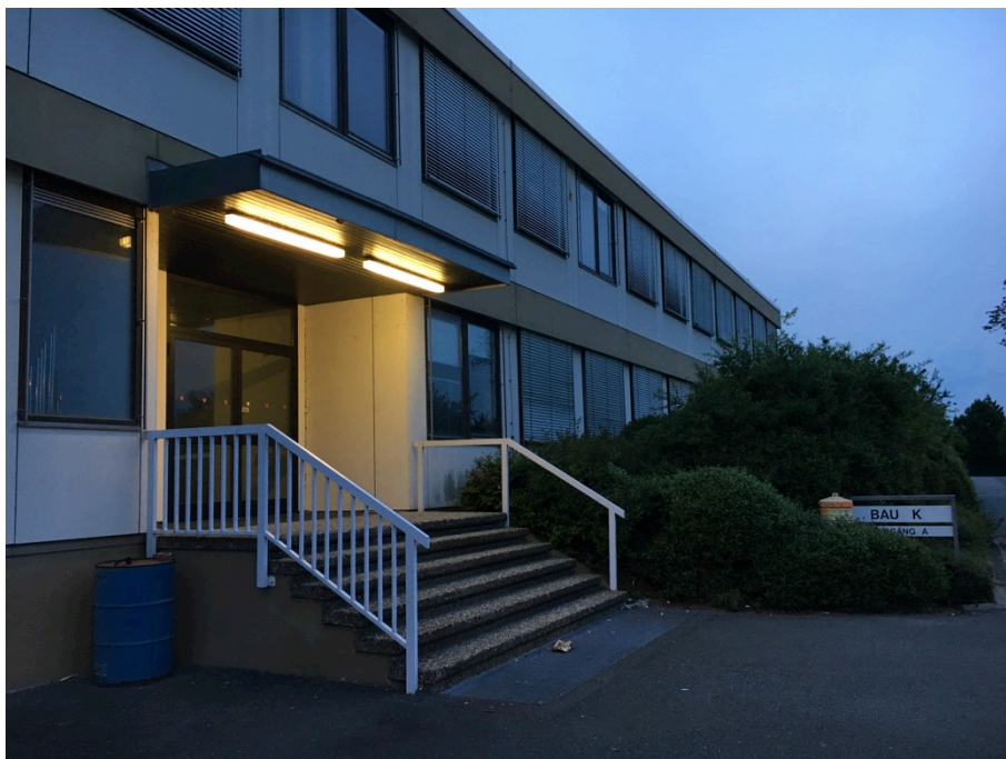
Abb. 2: Bau K: Ostseite ; Spalten hinter Fassadenverkleidung, Traufverblendung und Rolladenkästen
