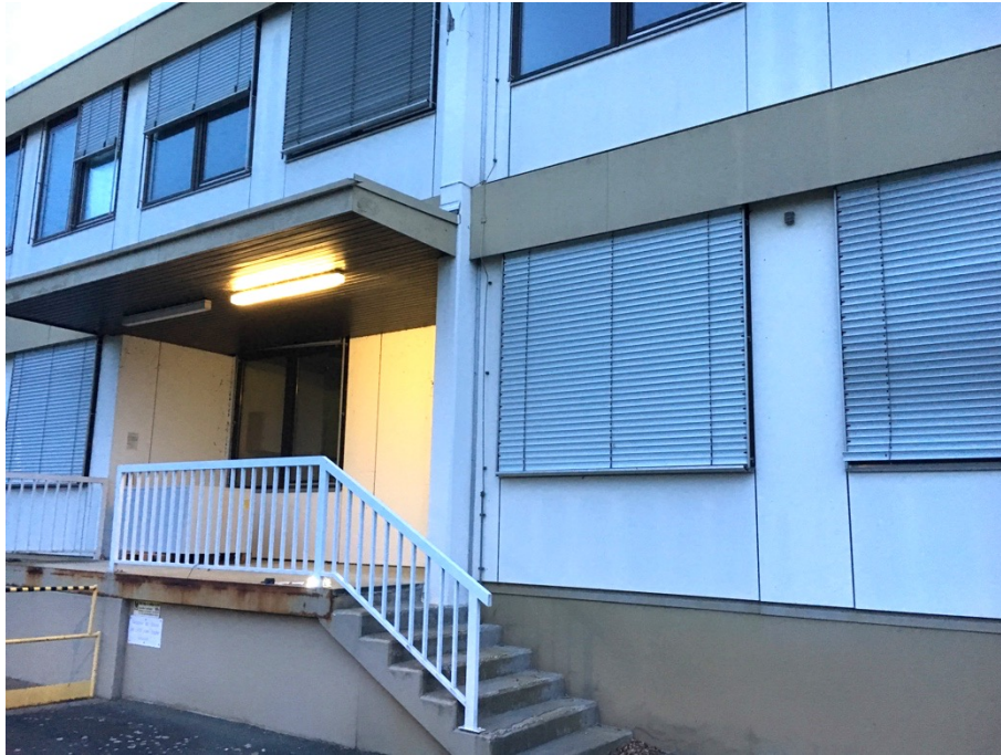
Abb. 1: Bau K: Ostseite ; Spalten hinter Fassadenverkleidung, Traufverblendung und Rollladenkästen
