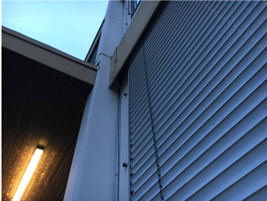
Abb. 3: Bau K: Ostseite ; Spalten hinter Fassadenverkleidung, Traufverblendung und Rolladenkästen
